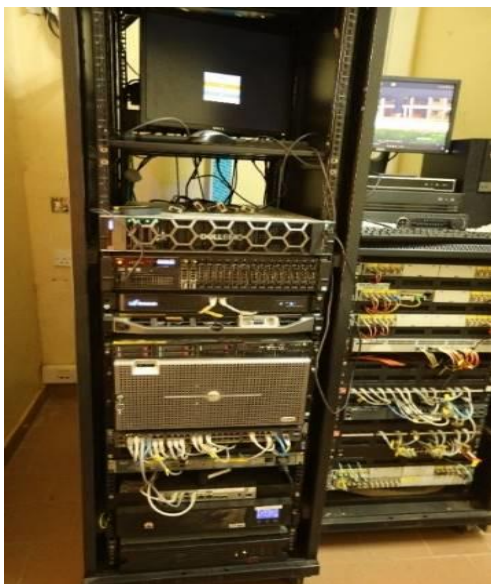
Figura 4 La "Server room" del Lacor attrezzata, migliorata e riorganizzata anche grazie ai fondi del progetto Hospital Evolution Project e, soprattutto, grazie al lavoro dei 4 membri del dipartimento IT dell'ospedale.
